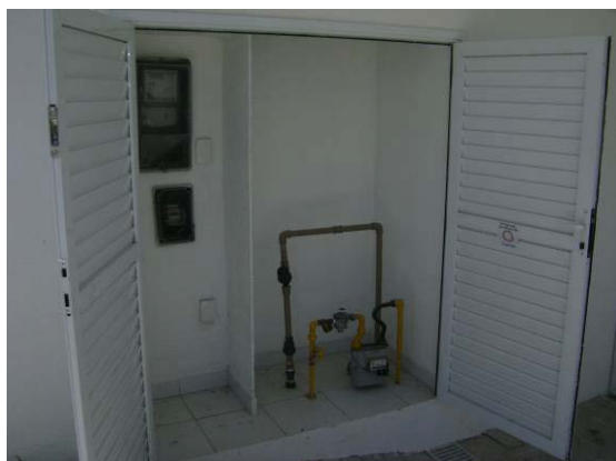
Fig. 05: Vista interior do compartimento de medição
