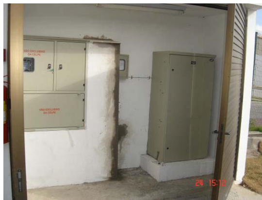
Fig. 04: Vista interior do compartimento com a medição do condomínio e QDG
