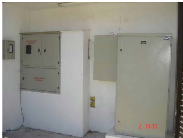
Fig. 08: Caixa de Telemedicação Instalada no Posto de Medição
