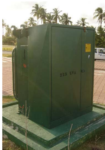
Fig. 03: Transformador Pad-Mounted de 225kVA
