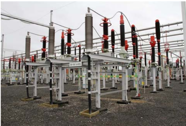
Fig. 9: AIS substation in Koksijde
